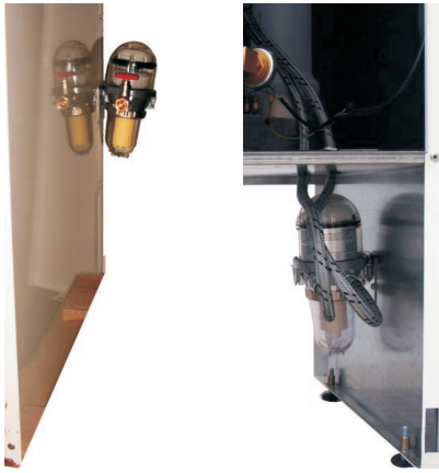
Φίλτρο πετρελαίου εξωτερικά του λέβητα θέρμανσης
